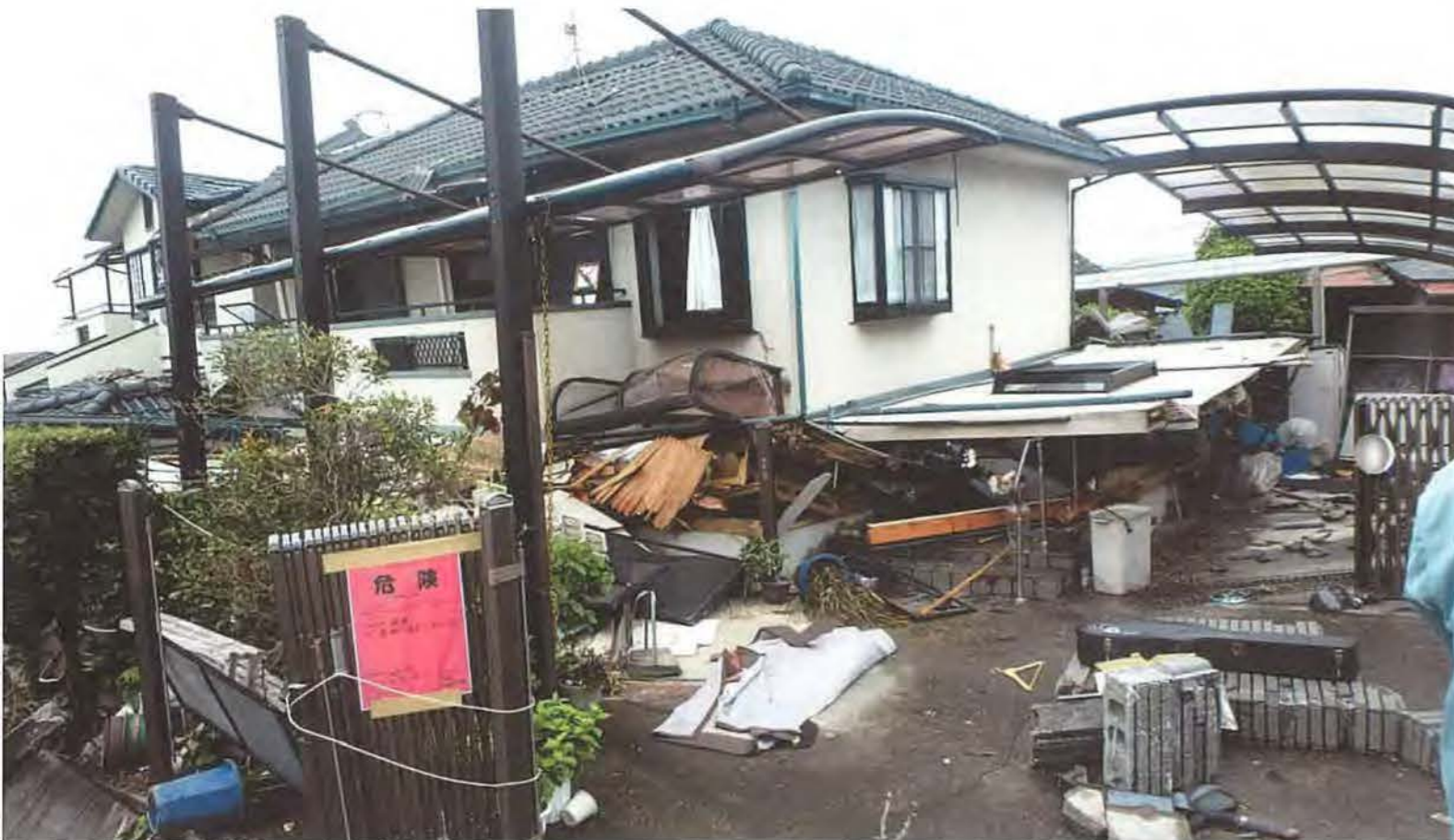
次ページの写真含め、すべて益城町で撮影したもの。上は地震動で1階が崩壊し、向かって左方向へ倒れ込んだ戸建て住宅。
