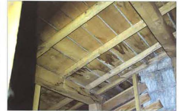
小屋裏に生じた水染み
