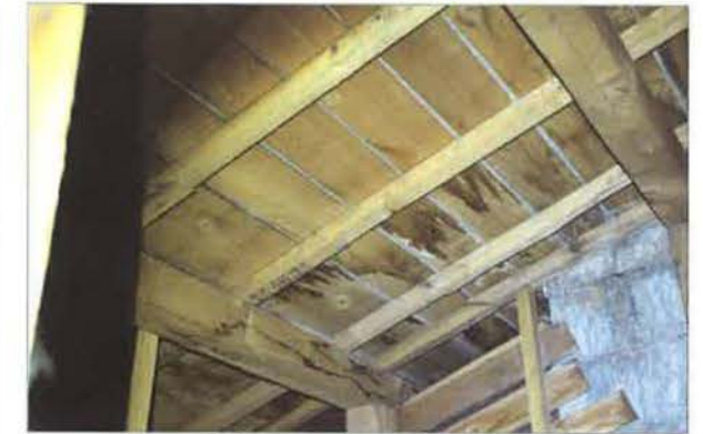
小屋裏に生じた水染み
