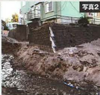
地盤が液状化した札幌市清田区里塚の道路。破損した水道管からは水が流れ続けていた。
