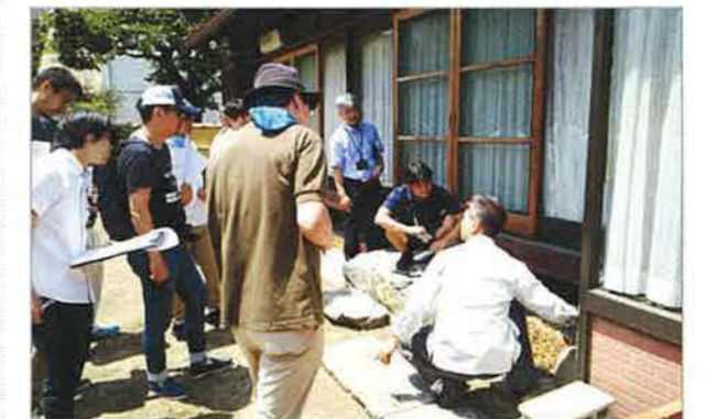
基礎部分のひび割れ事象診断について聞き入る参加者
