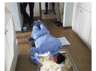
▲全員床下の不具合箇所を目視で確認しました
