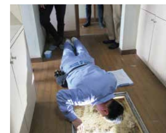
▲全員床下の不具合箇所を目視で確認しました
