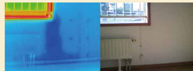
▲ 暖房機の配管もれ
