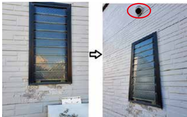
▲ 外壁のサイディングに損傷が見られる
